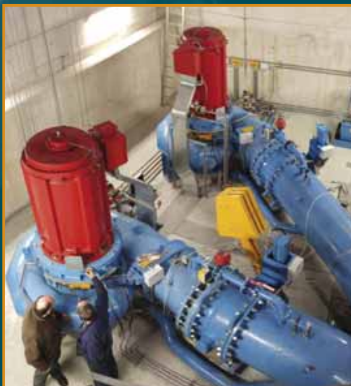
Centrale idroelettrica con due unità parallele
